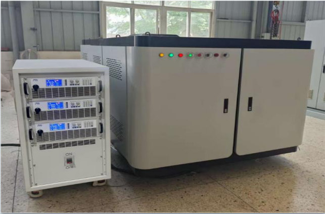
30kW SOEC电解水制氢装置
