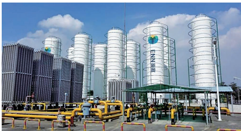
公司天然气厂站
