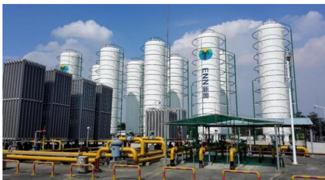
公司天然气厂站
