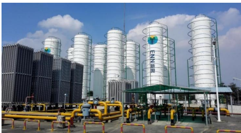
公司天然气厂站
