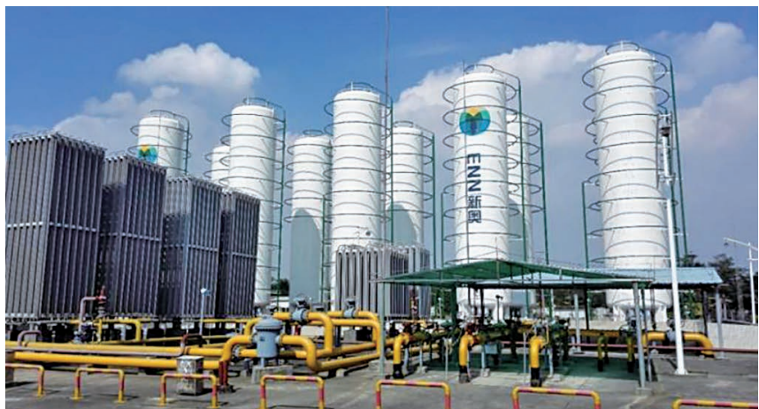
公司天然气厂站
