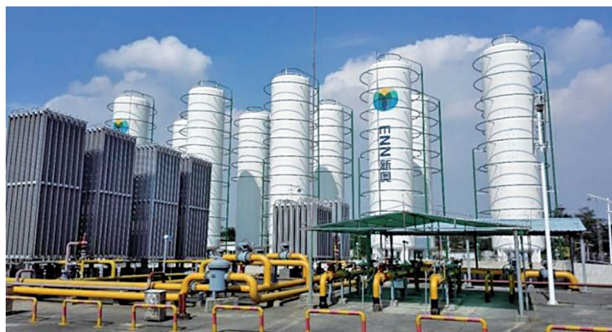
公司天然气厂站
