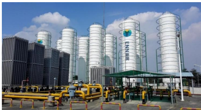
公司天然气厂站
