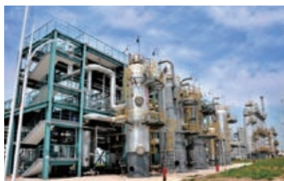
河南焦炉煤气制氢项目
