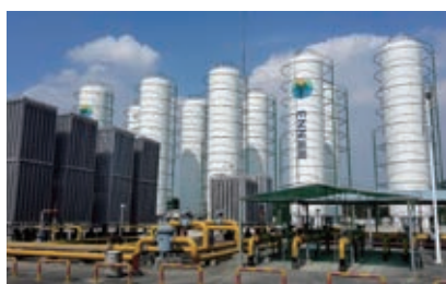
公司天然气厂站
